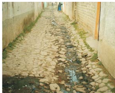
15. Descargas domiciliarias al aire libre.
