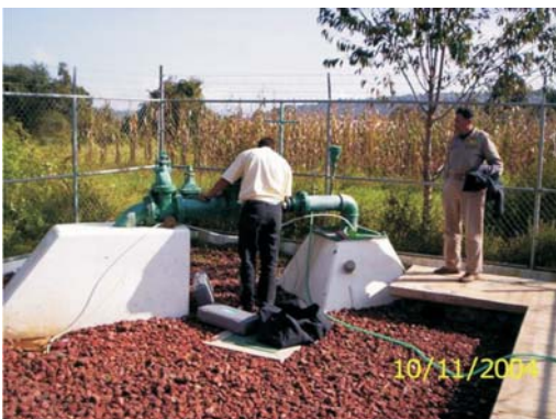
Imagen 68. Pozo para abastecimiento de la población.
