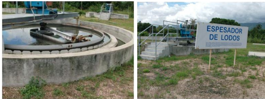
Planta de tratamiento en el Municipio de Chiapa de Corzo
