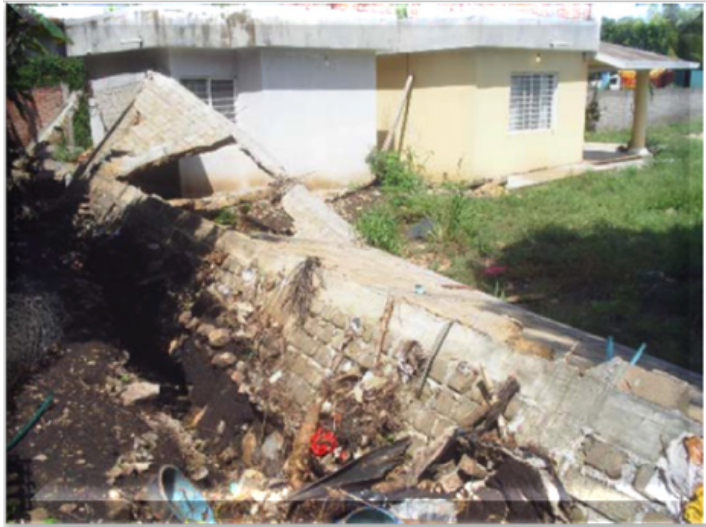
Avance del Arroyo Llano del Tigre sobre la zona urbana
