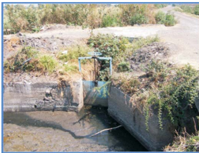
Estado de canales, azolve y deterioro.
