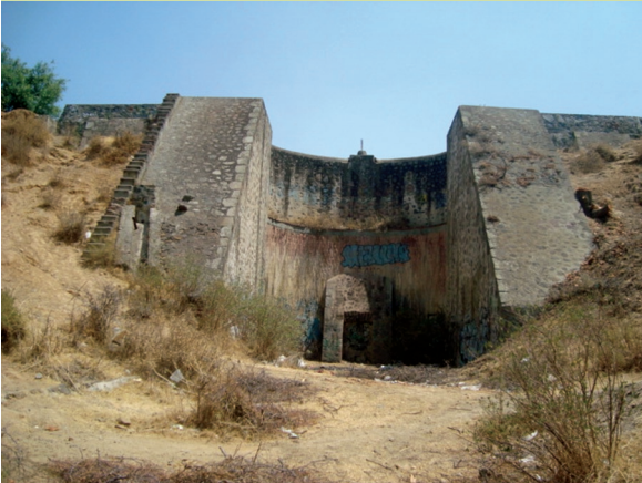
PRESA DE SAN AGUSTÍN O TEXALPA, EJIDO DE SAN FRANCISCO ACUAUTLA, IXTAPALUCA.
