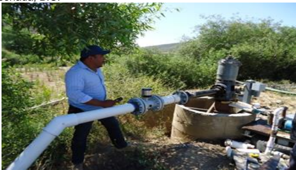
Figura 35. Personal de empresa contratada en instalación de medidor volumétrico en descarga de pozo de uso agrícola, Maneadero, Ensenada, B.C.
