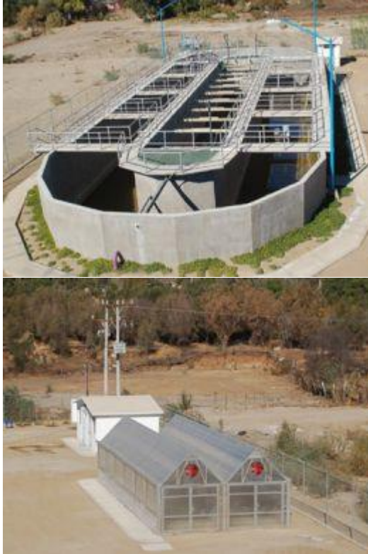
Figura 9. Planta de tratamiento de aguas residuales Francisco Zarco.
