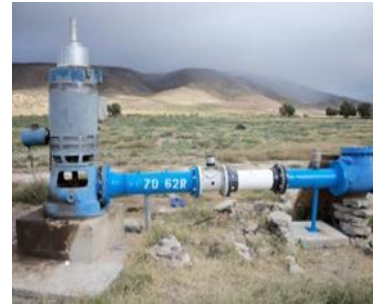
Figura 1. Ejemplo ilustrativo de pozo con medidor instalado
