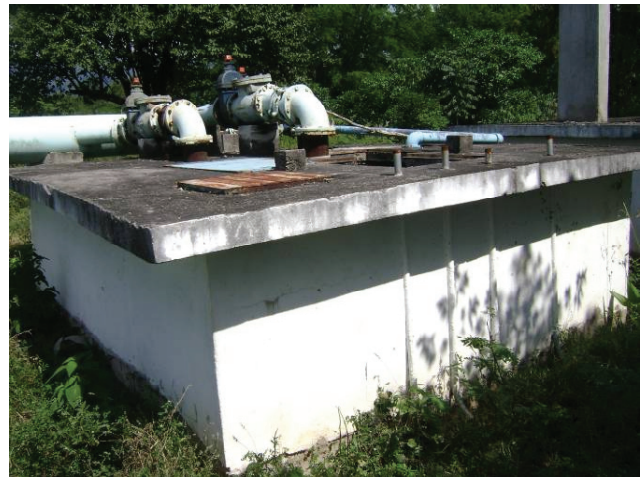
Fotografía 8: Planta de tratamiento de Agua.
