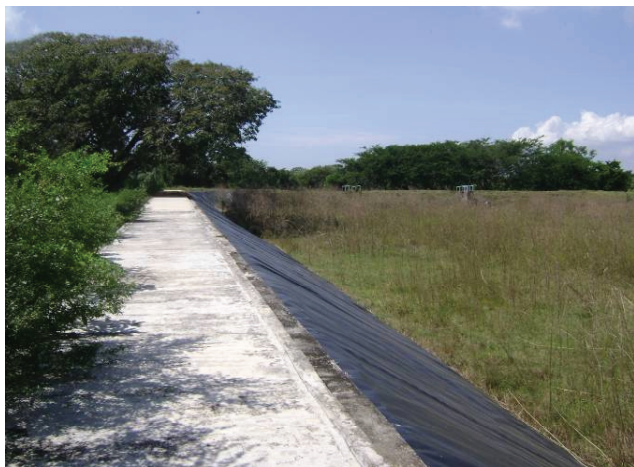
Fotografía 9: Planta de tratamiento de Agua totalmente Abandonada
