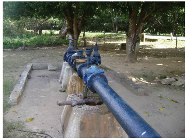
Fotografía 7: Estación No. 3 No funciona por descompostura de la bomba
