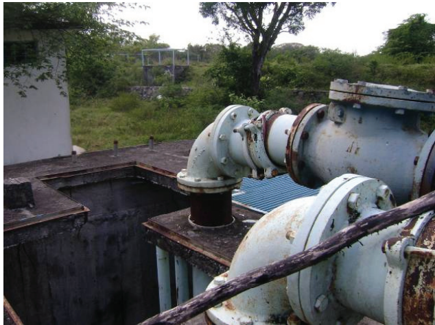
Planta de tratamiento. Tonalá
