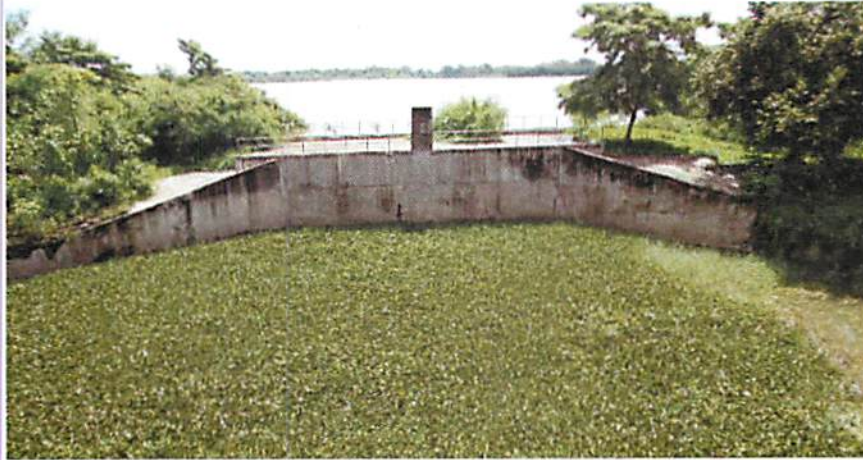
Figura 36. Compuertas para regular niveles de la Laguna Catazajá.
