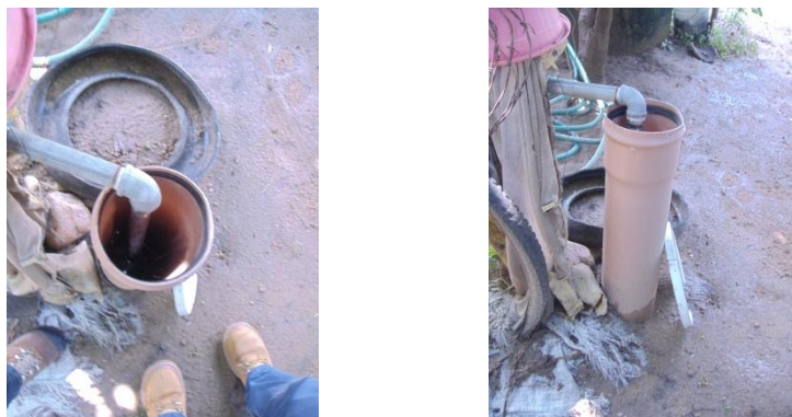
Figura 10. Pozos profundo de para abastecimiento de agua
